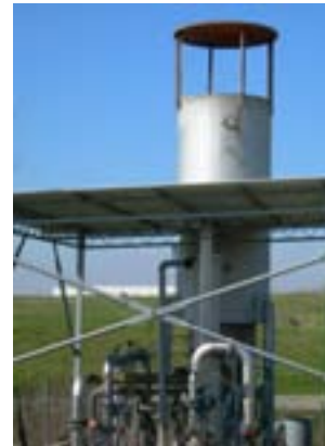
Torcia per la combustione del biogas (sistema di sicurezza in caso di blocco dei motori)
