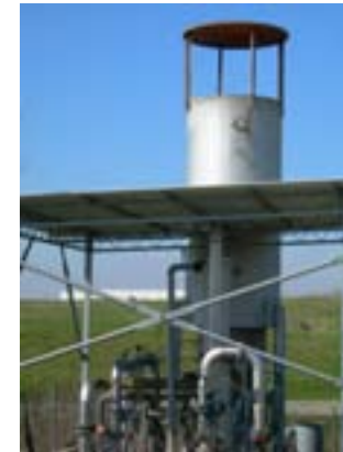
Torcia per la combustione del biogas (sistema di sicurezza in caso di blocco dei motori)
