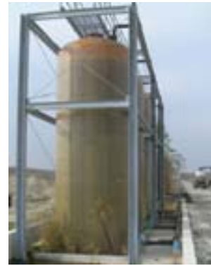
Cisterne di raccolta percolato
