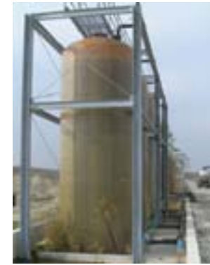
Cisterne di raccolta percolato
