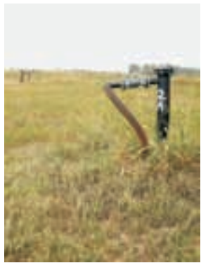
Sonda per l'estrazione del biogas installata nei lotti B+C
