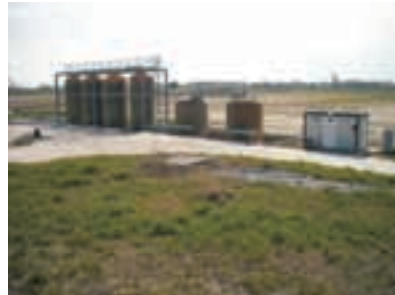
Vista delle cisterne di raccolta del percolato dei lotti A e B+C.
