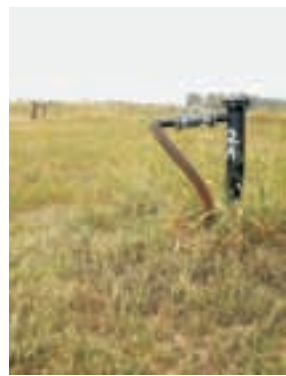
Sonda per l'estrazione del biogas installato nei lotti B+C
