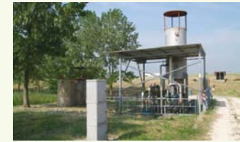
Torcia di combustione del biogas
