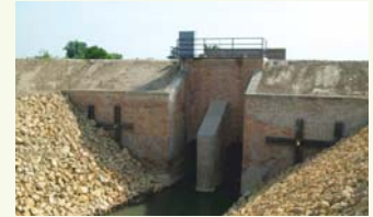
Conclusione dei lavori di sistemazione della chiavica posizionata nei pressi dell'ingresso alla discarica, a nord-est
