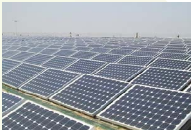
Vista dei pannelli fotovoltaici e dei supporti utilizzati
