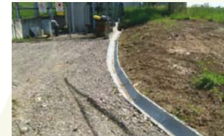
Canaletta di scolo realizzata nei pressi della torcia
