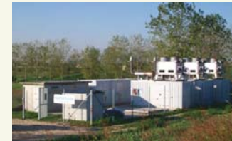
Impianto di combustione biogas
