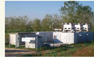
Impianto di combustione biogas
