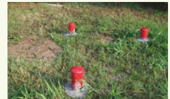
Nuovi piezometri della Tripletta 1 terebrati in prossimità dei precedenti, che risultavano danneggiati
