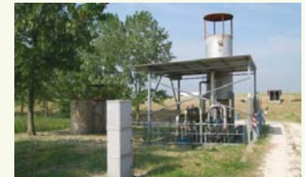
Torcia di combustione del biogas
