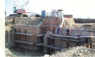
Lavori di sistemazione della chiavica posizionata nei pressi dell'ingresso alla discarica, a nord-est
