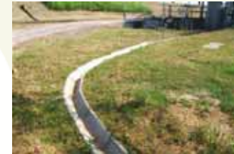
Canalette di scolo acque meteoriche nei pressi della torcia di combustione
