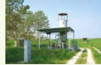
Torcia di combustione del biogas
