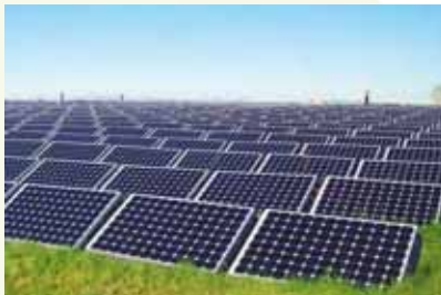
Vista dei pannelli fotovoltaici
