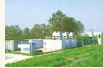
Impianto di combustione biogas
